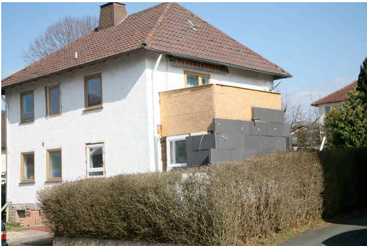
Abbildung 27: Teilbereich 8, Baukulturell problematische Sanierung in Eigenhilfe Quelle: eigene Darstellung
